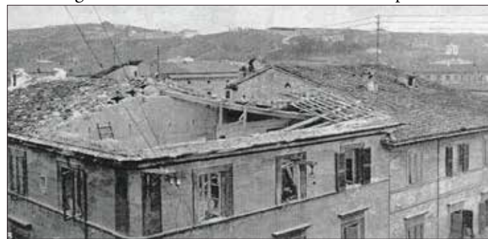
Beschädigtes Haus in Ancona, Via Cavourchie.
